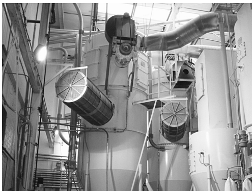
写真-3 バグフィルターに設置された IQR
