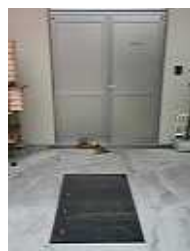
グリストラップ設置状況
